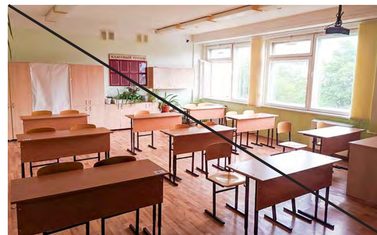
Плохо Линолеум под дерево
