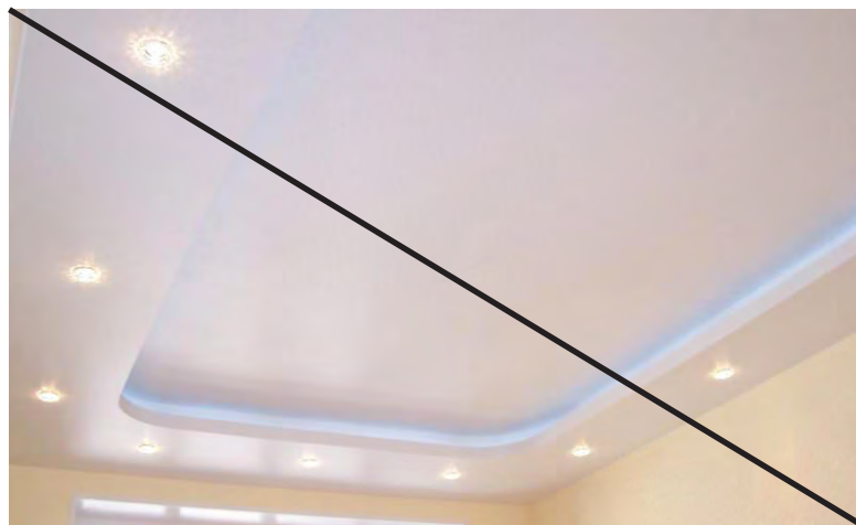
Плохо Многоуровневые гипсокартонные конструкции
